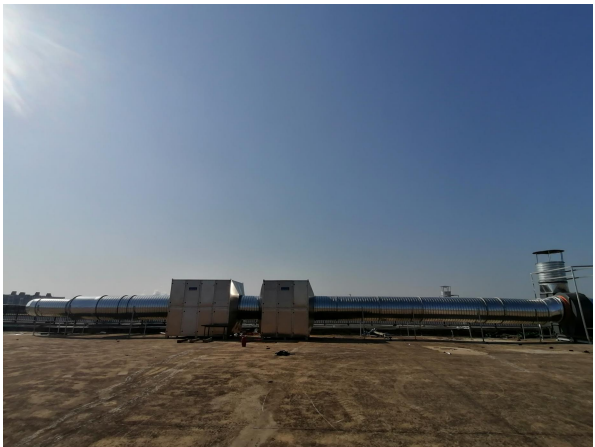
有机废气净化治理设施5# (DA005)
