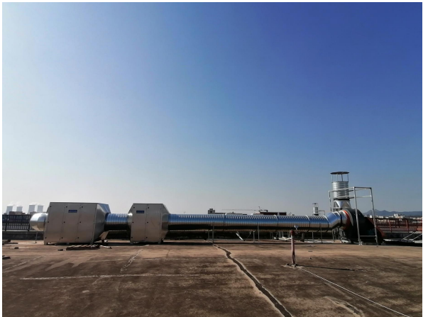
有机废气净化治理设施6# (DA006)
