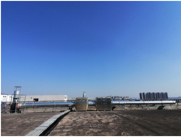
有机废气净化治理设施 3# (DA003)
