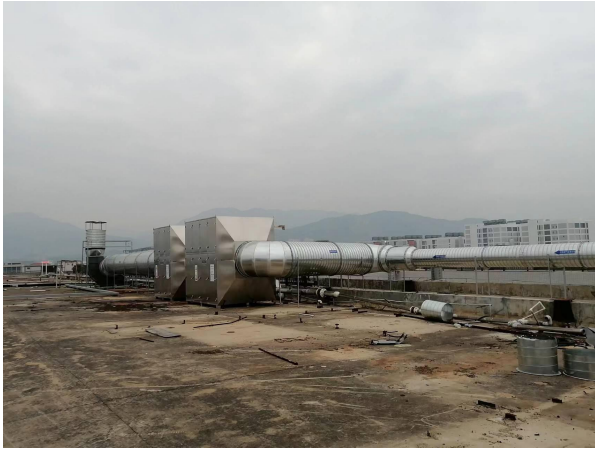
废气净化治理设施 1# (DA001)
